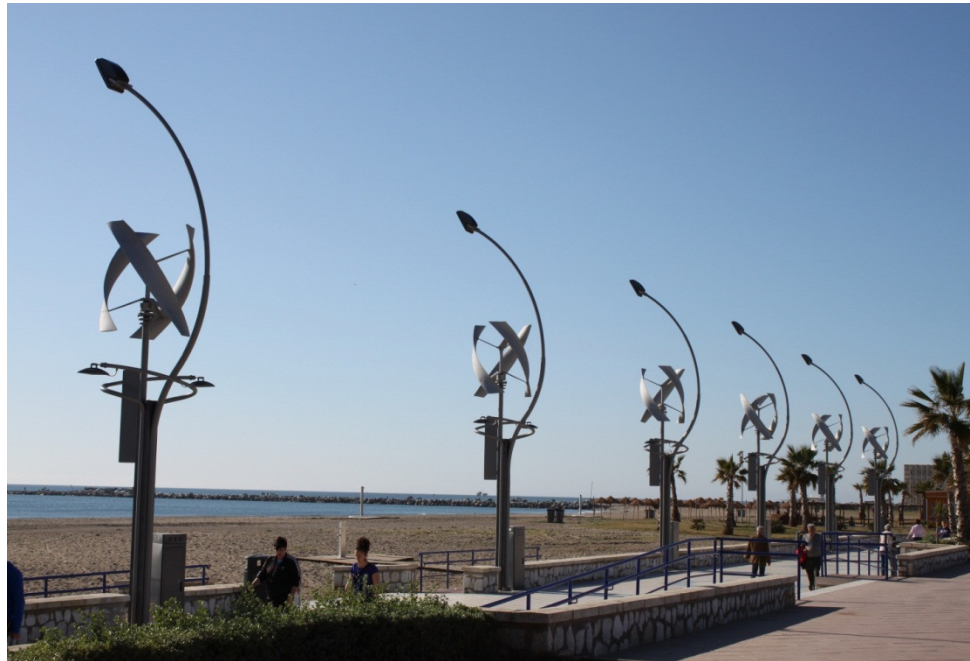
Instalación de alumbrado público alimentado con energía micro eólica, en el Pº Marítimo Antonio Banderas
